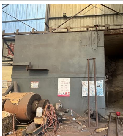
探伤室大防护门
