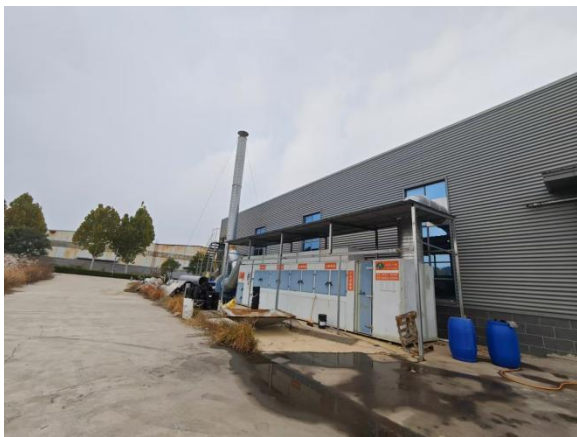
车间西南角排气筒
