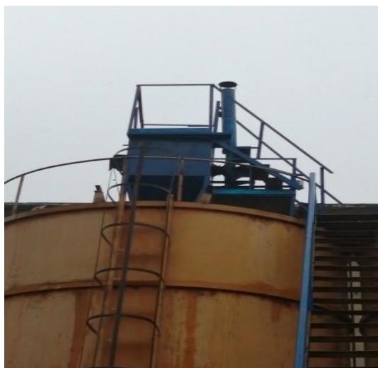
收尘治理设施
