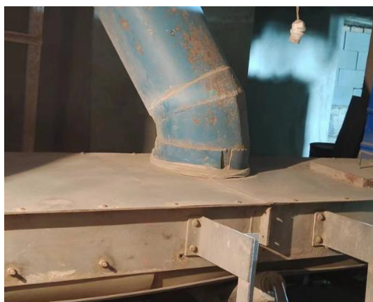
配料皮带封闭收尘
