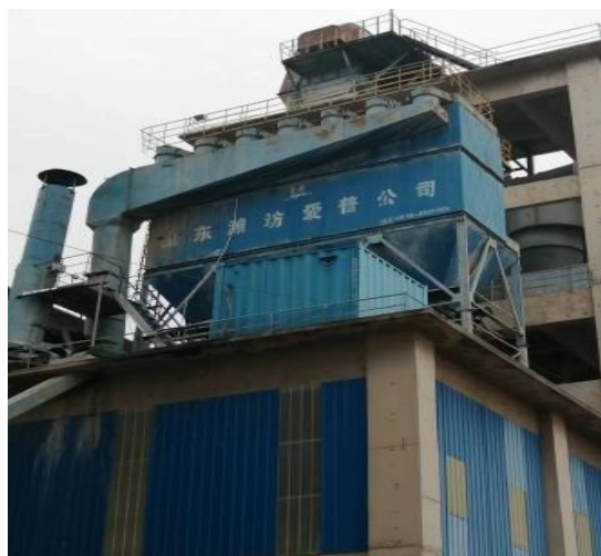
收尘治理设施
